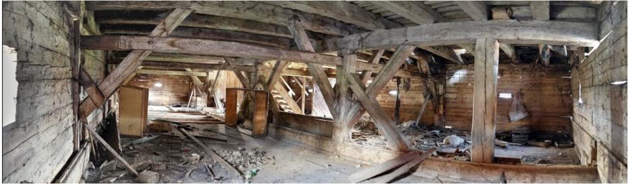
Rys. 8. Panorama wnętrza spichlerza w Rachowicach na parterze. Można zauważyć zły stan techniczny podłogi oraz duże nagromadzenie odpadów. Źródło: opracowanie własne.
