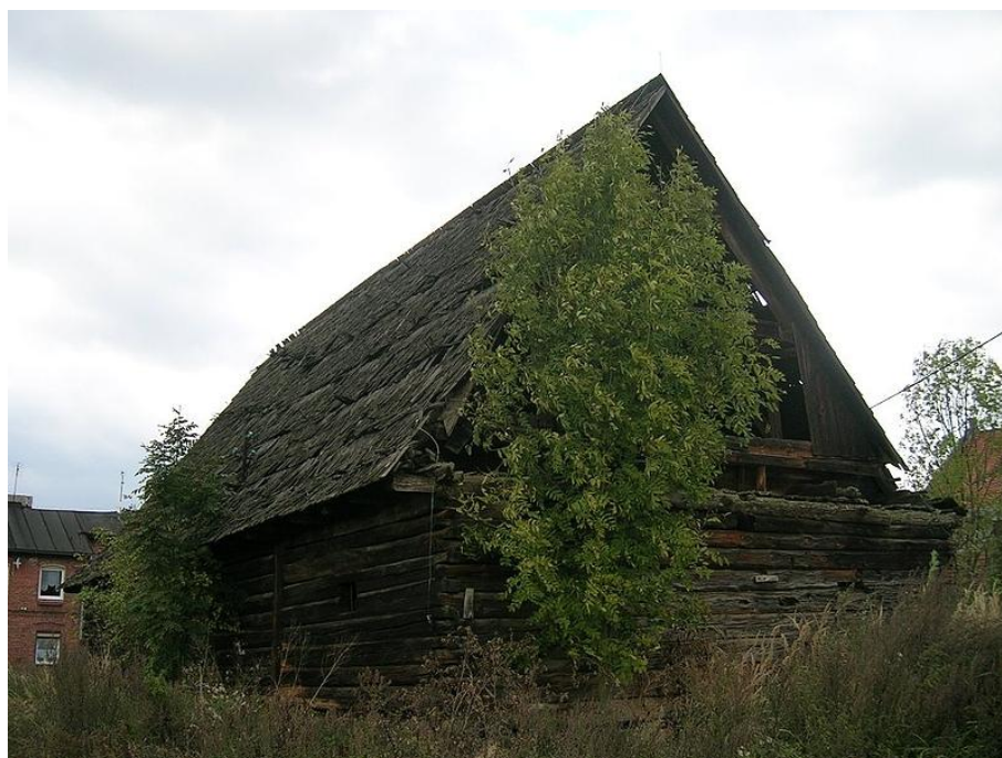
Rys. 4. Zdjęcie spichlerza w Rachowicach z roku około 2000. Można zauważyć duże zniszczenia pokrycia dachu i ścian szczytowych oraz rozpleniającą się roślinność w bezpośrednim sąsiedztwie spichlerza. Źródło: http://www.polskiekrajobrazy.pl/ , autor: Brygida Kicińska
